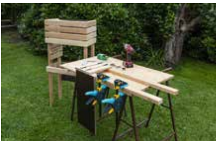
22. Nach bewährtem Prinzip die drei ersten Rhombusleisten links anschrauben. Die rechten Leisten dieses Moduls sind ja bereits an dem hohen Teil des Regals vorhanden.
