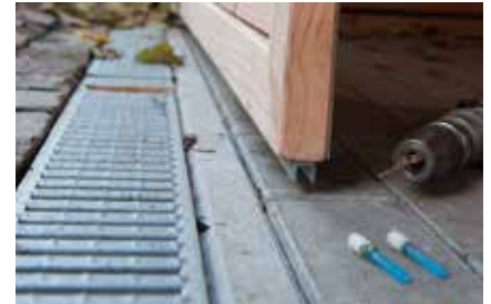
27. Am Boden läuft die Bodenführungsschiene mit den Bodenführungsrollen.
