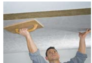
In der Regel gilt: Dicke, gut gedämmte Wände und Decken verbessern den Schallschutz. So spart die Dämmung der Kellerdecke nicht nur Energie, sondern hält auch die Geräusche des Heizkessels im Untergeschoss. Foto: Isover
