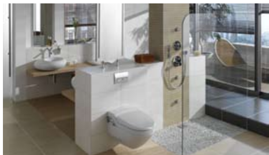
Kreative Raumaufteilung: In kürzester Zeit ist die komplette Wunschinstallation fertig zur Verkleidung. Fotos: Geberit
